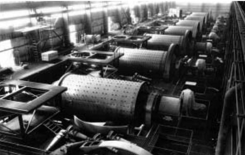
Planta de molienda del Concentrador Colón.
